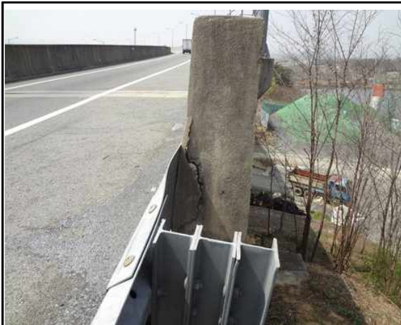
A1측 들뜸 및 파손
